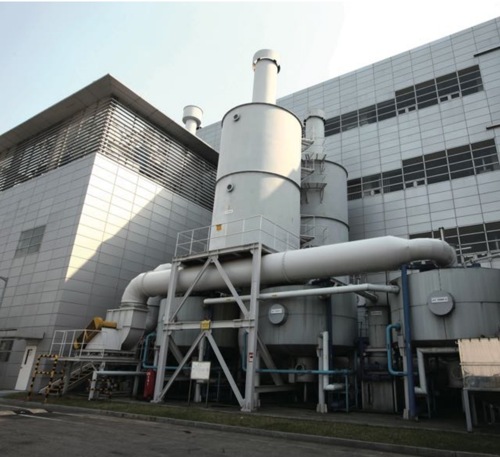
• 노루오토코팅 화성공장 대기오염방지설비 RTO(Regenerative Thermal Oxidizer)
